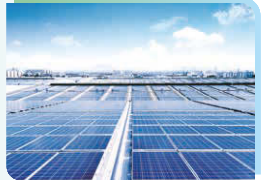
中山格兰仕屋面分布式太阳能光伏发电应用示范项目
