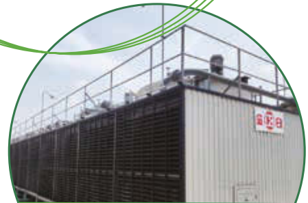
重庆国际复合材料股份有限公司 中央空调和工艺循环水节 能改造项目
