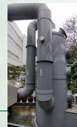
废气治理设备
