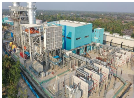
图 7：孟加拉 300MW 联合循环电站
