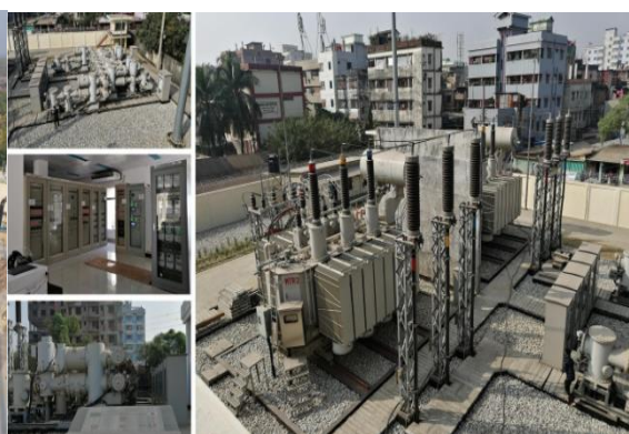
图 8：孟加拉 132kv 变电站
