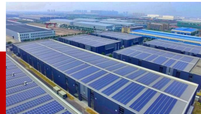
临港奉贤园区屋顶光伏电站
