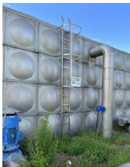
开展蒸汽冷凝水回收再利用项目
