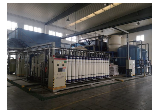
阿波罗污水深度处理回用设施
