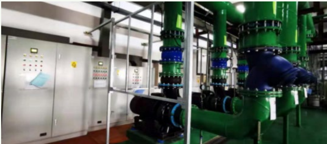
空调水泵变频系统
