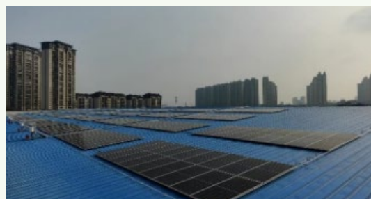
光伏发电项目
