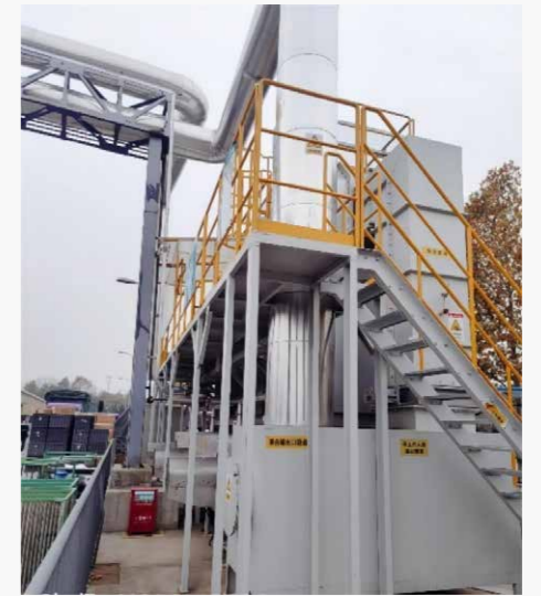
青岛海信日立空调VOCs废气排放处理示范项目
