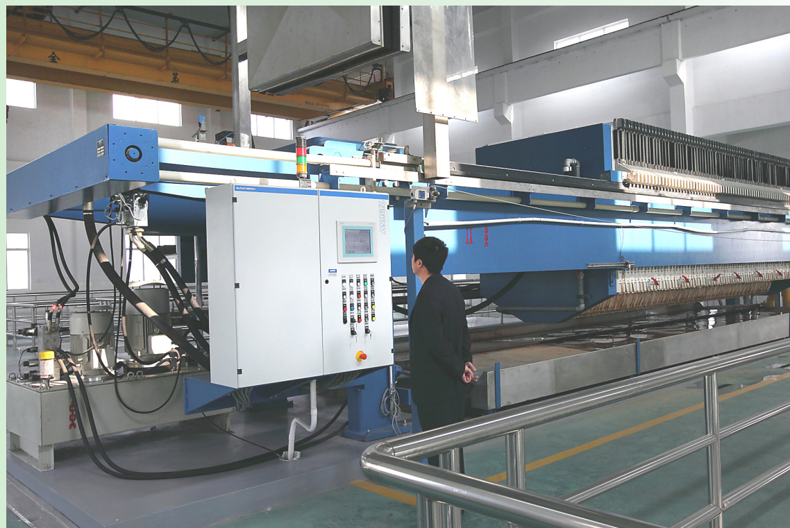
污泥脱水系统设备
