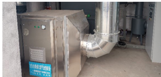
▲ 公司漆包废气治理设施
