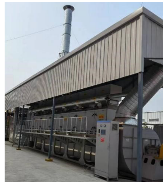
在线催化燃烧环保处理设施
