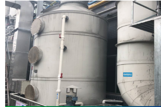
方案实施前使用的水喷淋装置
