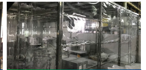
方案实施后化工一车间离心工序密闭装置
