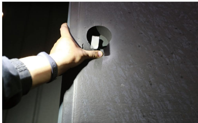
封闭式空压机房采用15cm厚度隔音棉降噪
