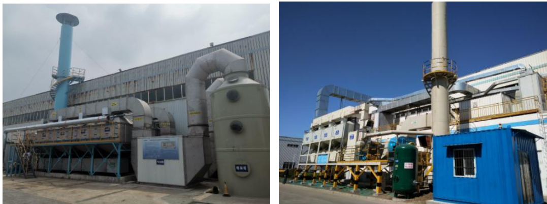
环保治理设施
