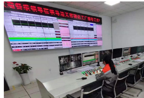
长和电力磷化工厂搬迁后控制室
