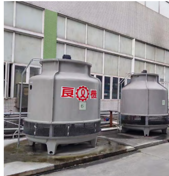
水循环冷却塔
