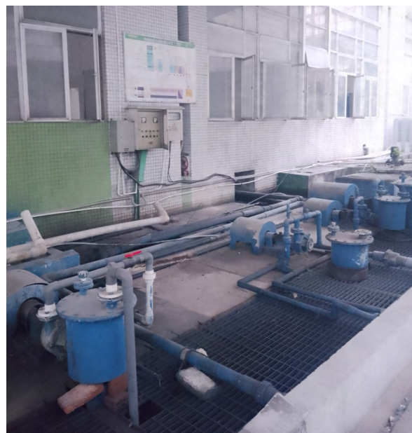
园区污水处理站
