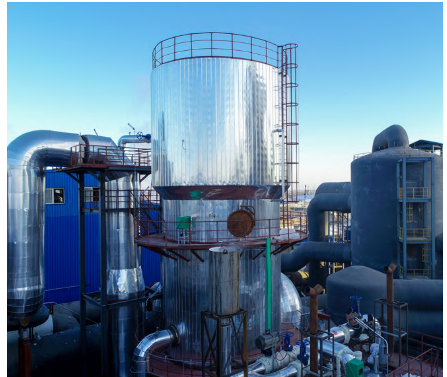
黑龍江紫金銅業的低溫餘熱回收設備
