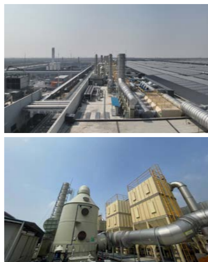
废气治理设施
