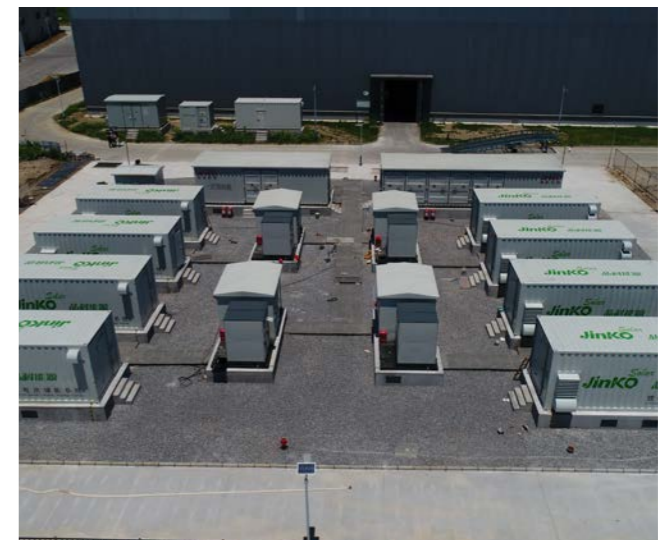
浙江海宁晶科能源储能项目厂区
