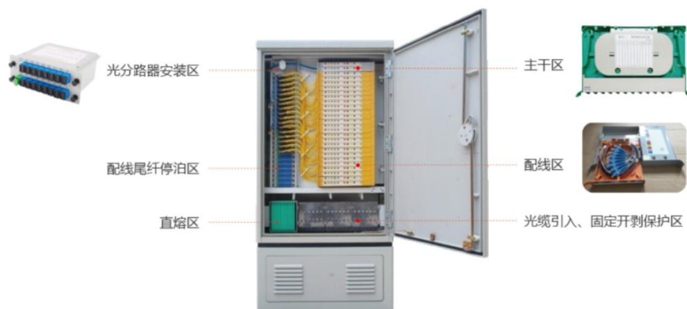
图：无跳接光缆交接箱
