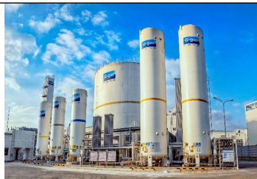
深圳现场制气项目
