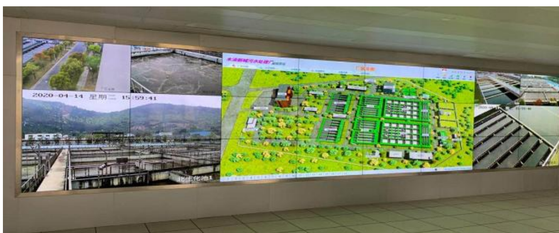
图：苏州市吴中区木渎新城污水处理厂委托运营项目
