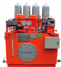
水电站进水蝶阀液压系统
