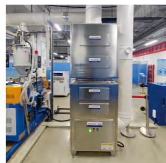
两级活性炭净化装置
