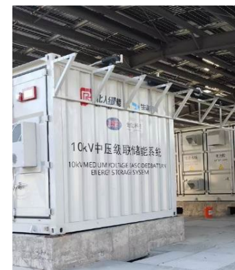
浙江台州信质股份用户侧 15MW/30MWh 储能电站
