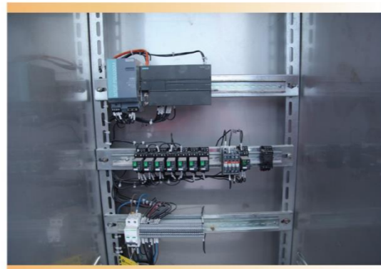
▲黑河洛克尾矿库输送机控制系统技改后
