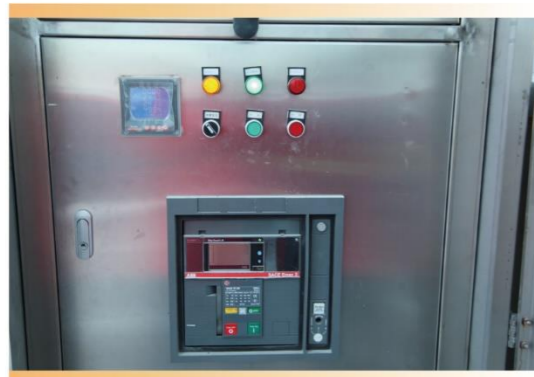
▲黑河洛克尾矿库输送机控制系统技改前
