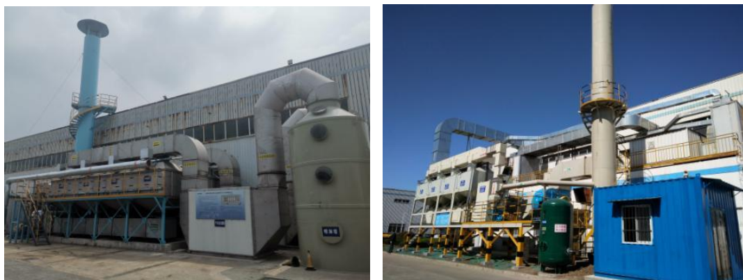
环保治理设施
