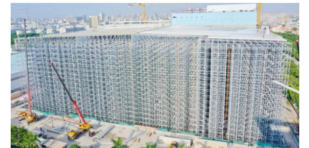
深圳禾美冷库全景图
