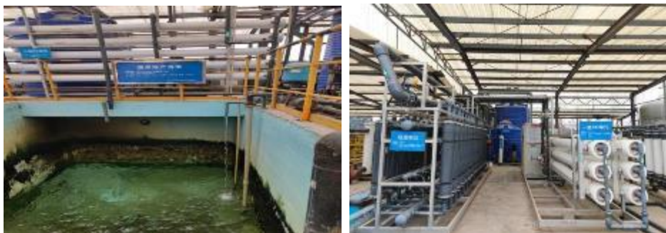
▲工业废水、生活污水集中处理
