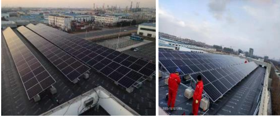
▲管具中心屋顶太阳能光伏发电
