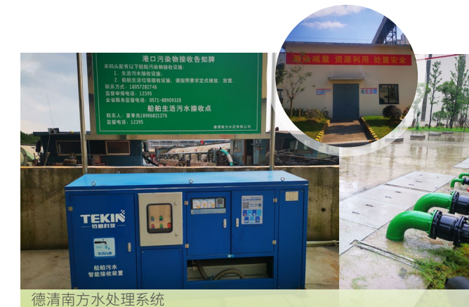
德清南方水处理系统
