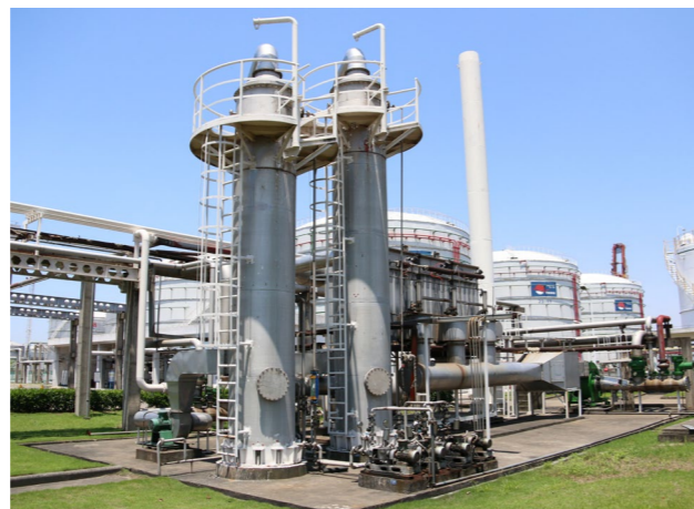
有机废气处理设施
