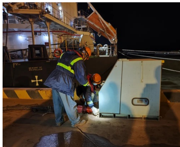
太仓武港码头 1 号泊位的“宝航 58”轮顺利接用高压岸电
