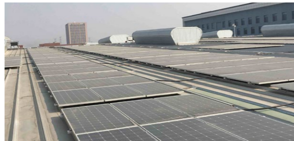
海尔生物园区光伏发电板
