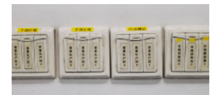
路灯照明分区开关
