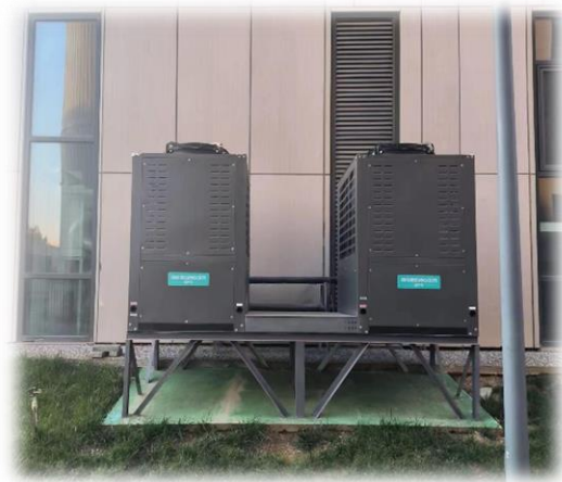
房山云计算中心员工宿舍楼增加电辅热设施
