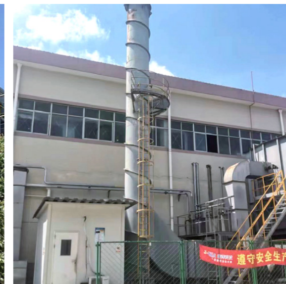
南洋公司蓄热式焚烧炉
