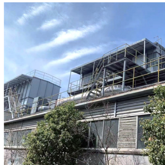
东旭成蓄热式焚烧炉
