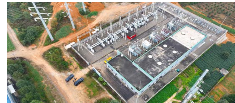
乐山电力 110 千伏合兴变电站 3 号投运
