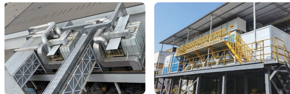
小蓝工厂沸石转轮+RTO 治理设施 / 车桥厂 CO(催化燃烧)设施
