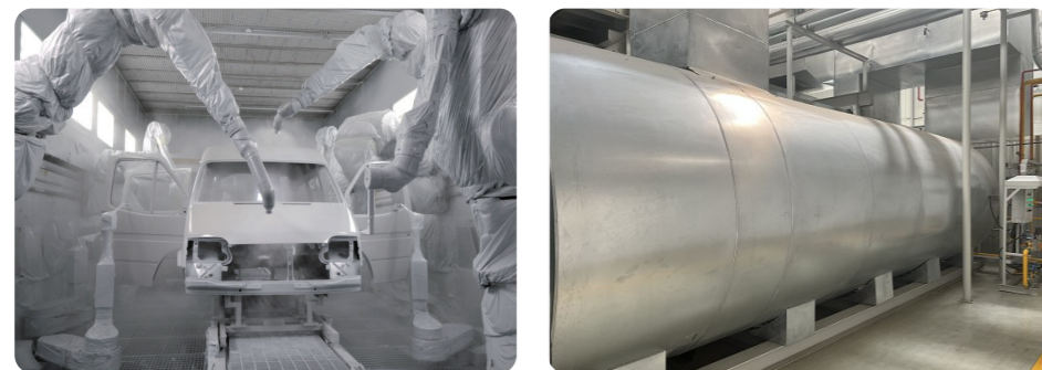
机器人自动喷涂 / TNV(热回收式)焚烧炉
