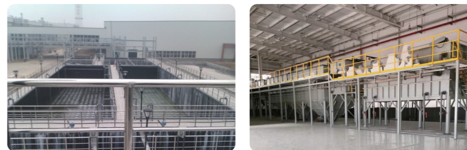
小蓝基地废水处理系统 / 富山基地废水处理系统
