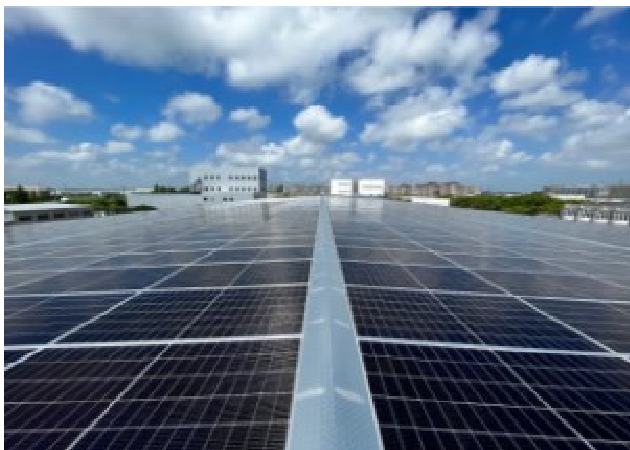
紫丹印务 886KW-EPC 光伏项目
