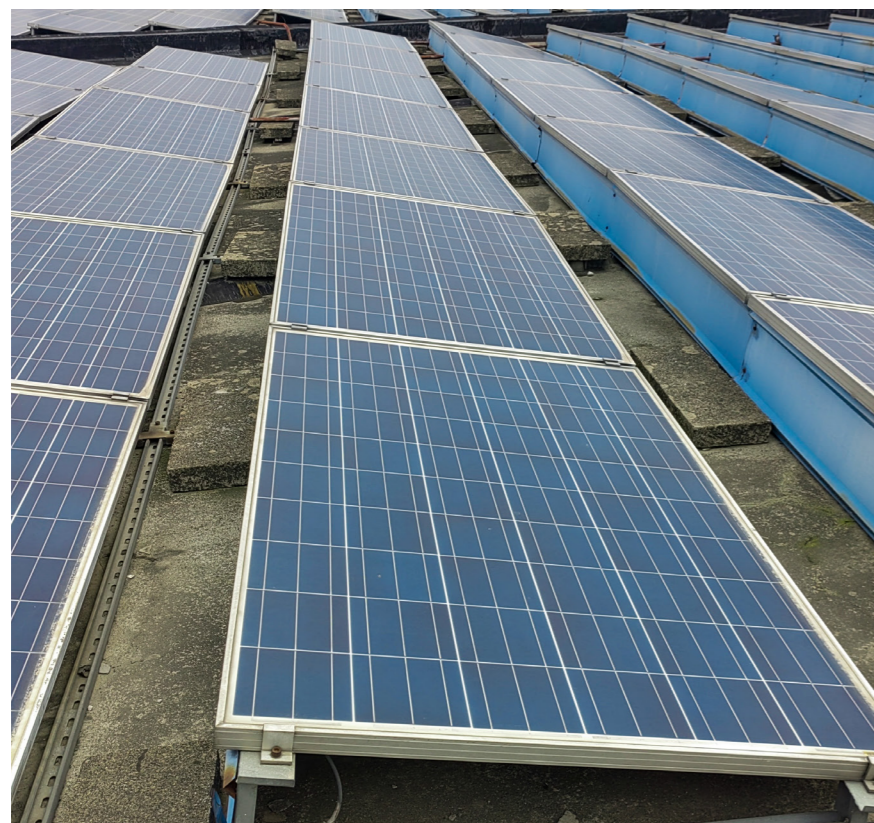
图注: 厂区内使用光伏等再生能源
