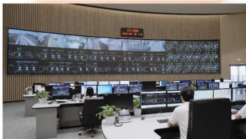
ISCS综合监控 全线联动综合监控
