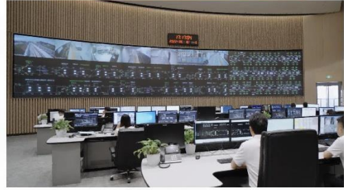
ISCS综合监控 全线联动综合监控
