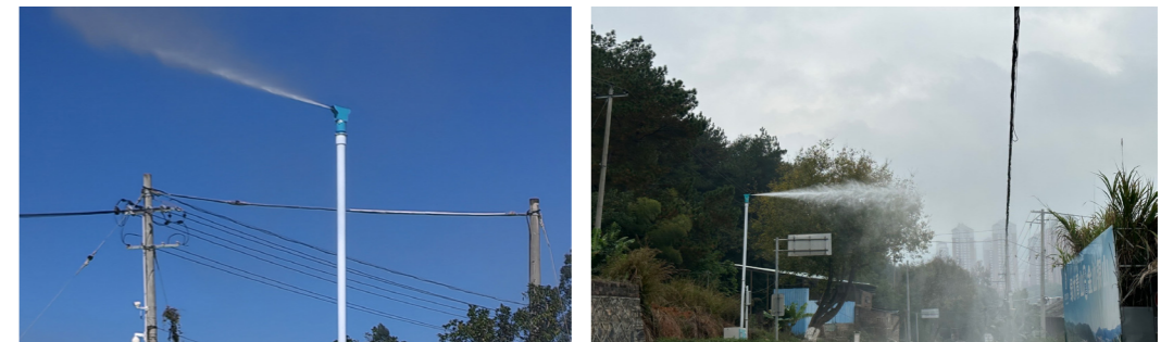
高压喷雾桩降尘系统
