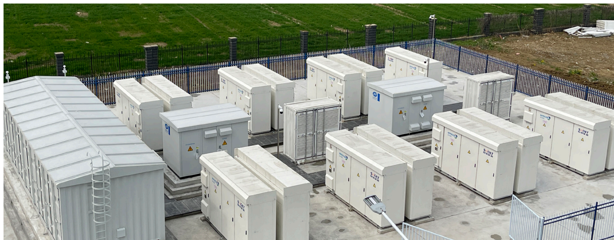
江苏常州蜂巢 9.03MWh 储能项目全景
