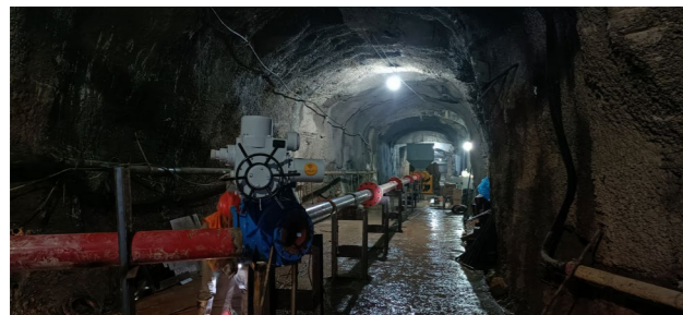
尾砂膏体充填管道
