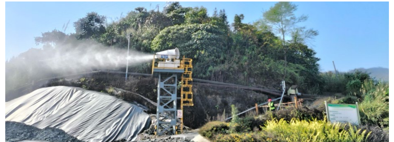
华联锌铟大坪选矿车间喷雾降尘装置
