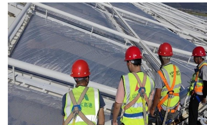
红河项目大雨棚气枕膜专项质量检查活动
