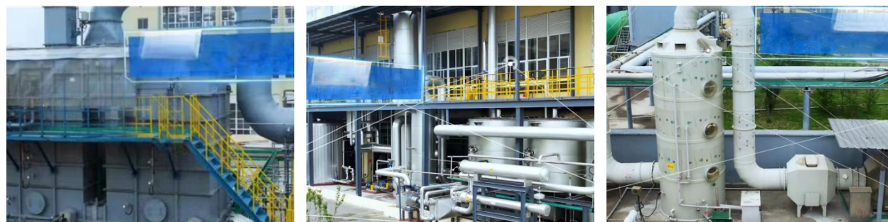
▲ 公司废气处理系统
