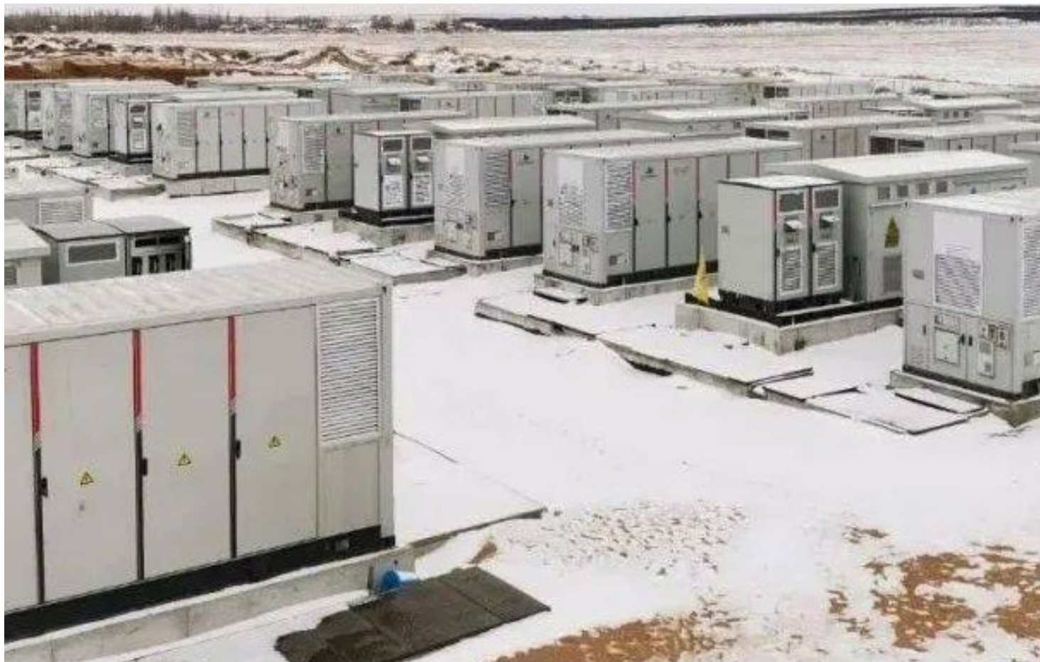
BattCool 储能全链条液冷解决方案应用于宁夏某百兆级储能项目
