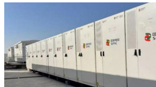
宁夏穆和储能电站项目
