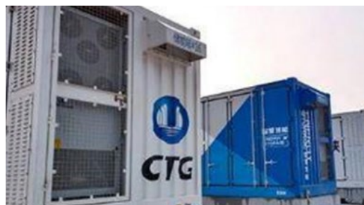
三峡能源庆云储能电站示范项目
