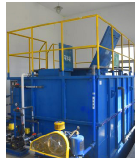
污水处理设备操作间
