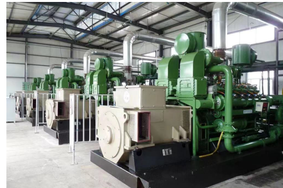
余吾煤矿瓦斯发电项目
