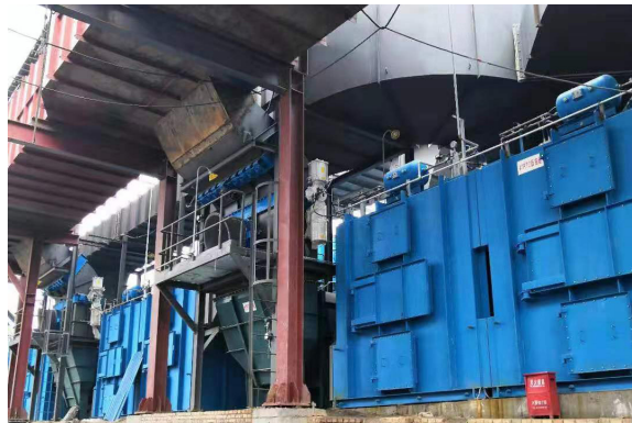
余吾煤矿瓦斯供热项目
