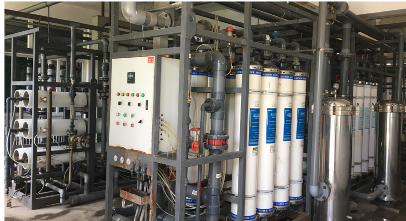
公司下属夏店煤矿矿井水超滤反渗透工艺处理设施
