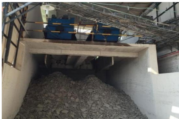
压滤泥回收处理
