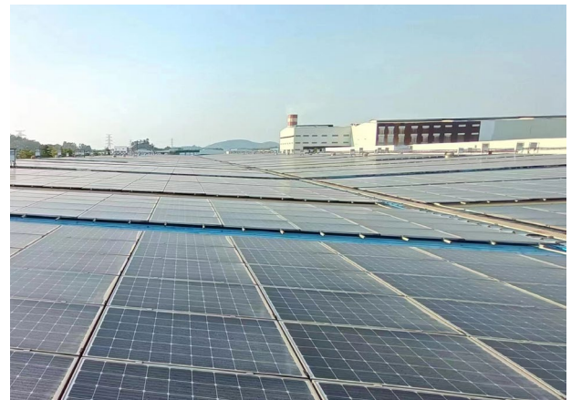
屋面光伏系统
