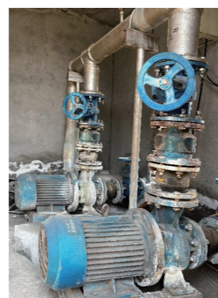
冷凝水循环水泵
